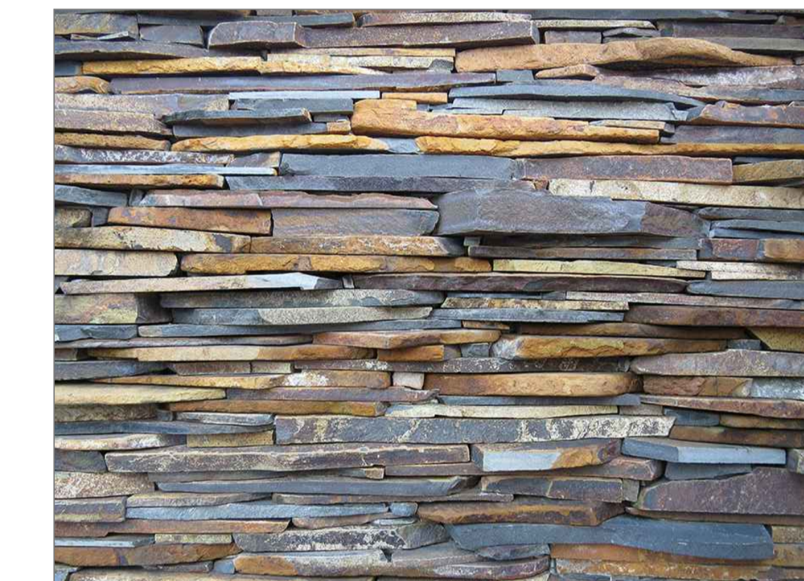
Assentamento de Pedras nas Muretas de Contenção O revestimento de pedra será executado com pedra de basalto ou pedra ferro, tipo palito. Serão de tamanhos variados, não polidas, com espessura variando de 02 de 06cm, formando relevo desigual. Serão assentadas com junta seca.
